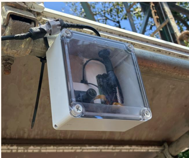
掘削現場監視用センサー
