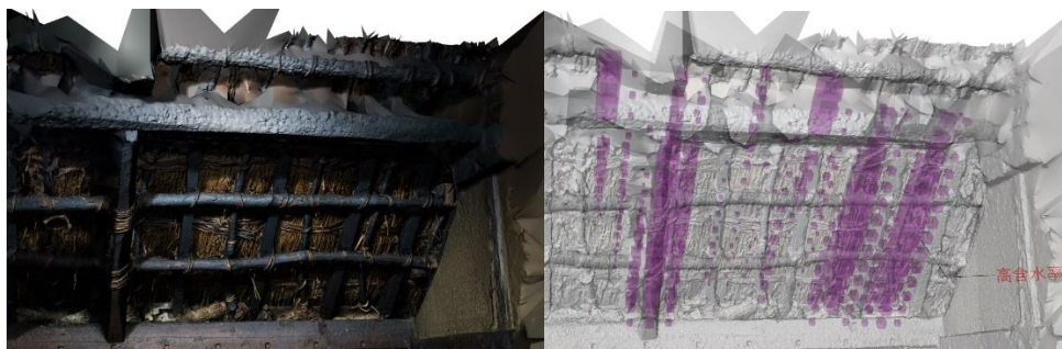
図 3. 茅葺屋根の雨の浸食の検出 (高含水率部分を大きい立体格子で表示)
