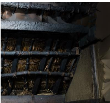
茅葺屋根の雨水浸食の検出
