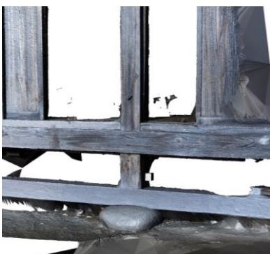
柱脚部の腐食の検出
