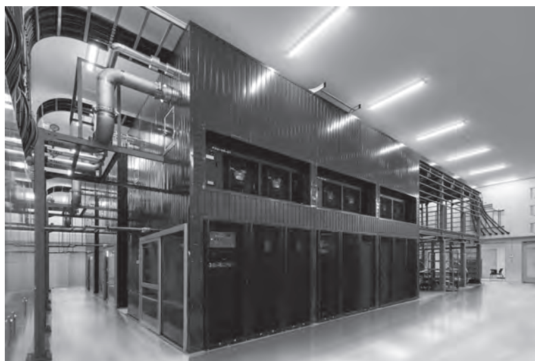
■ 図2-8-4 ABCIシステム外観
