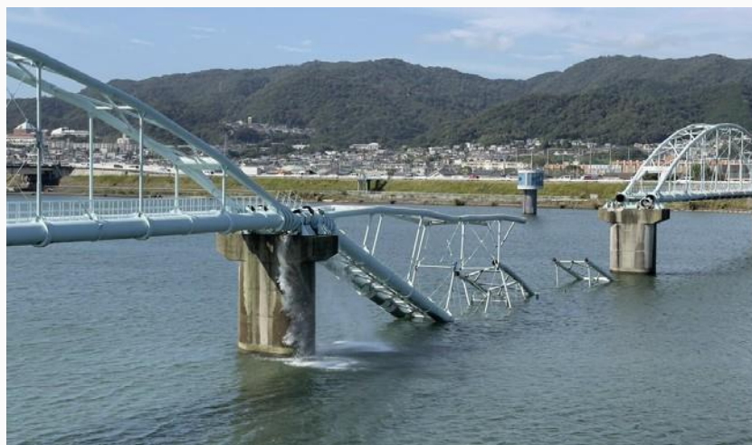
六十谷水管橋崩落事故
