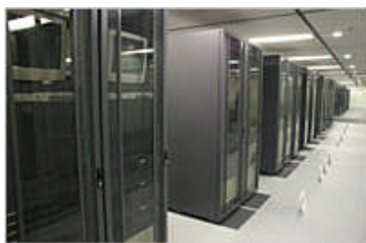
サーバールーム
